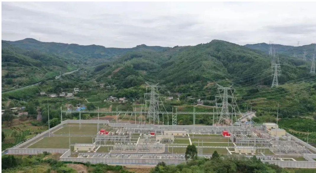
▲ 500千伏大林变电站俯瞰图
